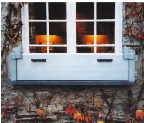
Hochwasserschutz an Fensteröffnungen
