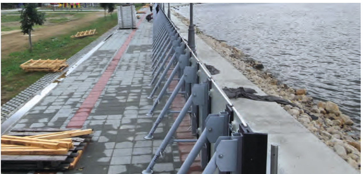
Hochwasserschutz mit Hochwasserschutzplatten aus Kunststoff
